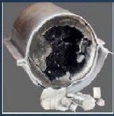
EXCESIVA EMISION DE NOX
